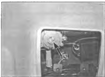
Рис. 22.3. Люк можно открыть и закрыть вручную, с помощью подходящей отвертки поворачивая вал электродвигателя
